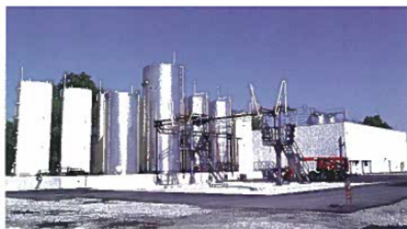
Photo ci-dessus et ci-contre : De la préfabrication en ateliers au montage comme ici la construction d'une usine d'émulsion : de la tuyauterie aux cuves, tout est réalisé par BPTEC.
